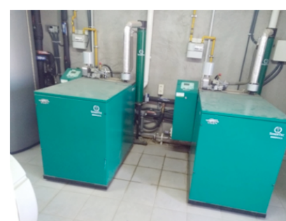
Calderes de cogeneració
